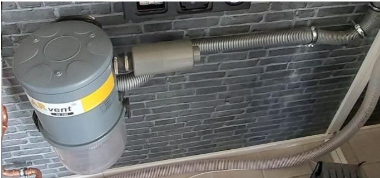
Abb. 23: Pellet-Saugturbine mit Schalldämpfer und Ansaugschlauchverlegung zur Pelletheizung
