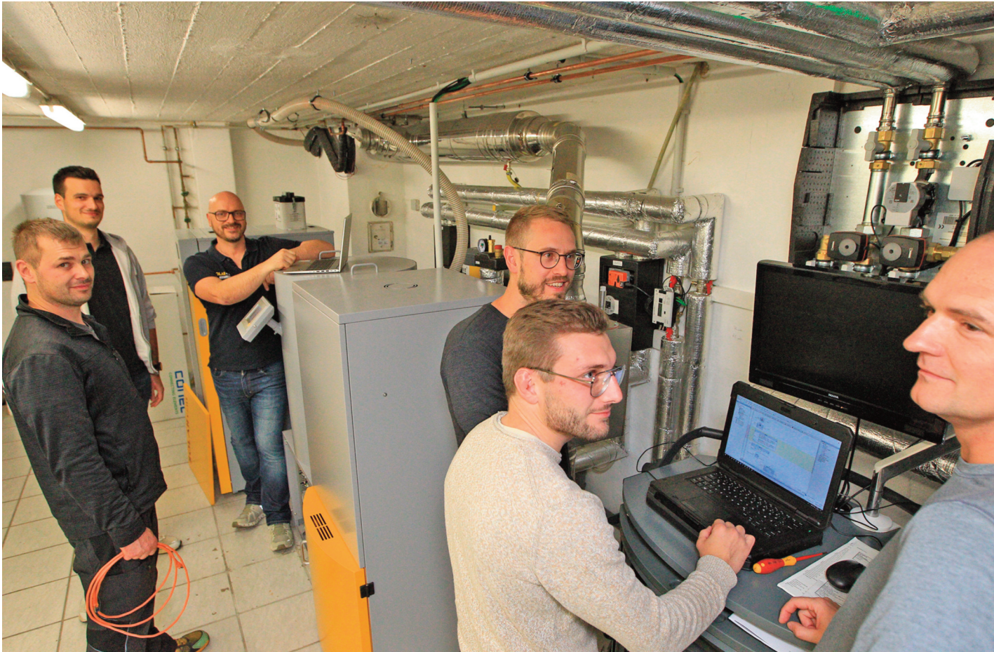
Größes Technikertreffen im Heizungskeller der Firma Solarvent; links hinten Solarvent-Mitarbeiter Sascha Cremer, Projektleiter Lukas Richter vom DBFZ und Solarvent-Geschäftsführer Dominic Umscheid, im Vordergrund Mitarbeiter der Firma Kermi und der TU Dresden bei der Einrichtung des Systems, das nun rund 18 Monate getestet in der Praxis wird. FOTO: Hillebrecht
